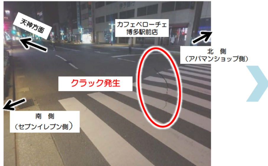
① 5:15頃 道路陥没（舗装クラック発生）
