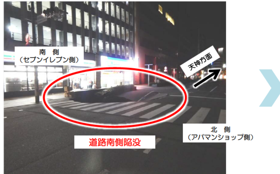
② 5:20頃 道路南側陥没
