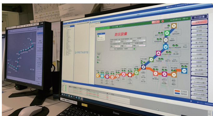
中央防災監視装置（運輸指令）
