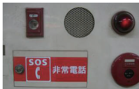
非常連絡装置
