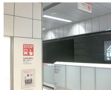
列車非常停止押しボタンと案内板
