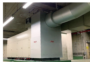
非常用発電機
