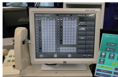
七隈線用列車無線
