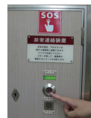
非常連絡装置
