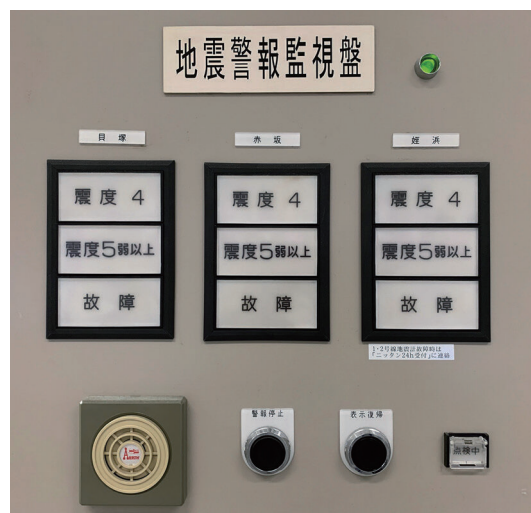
地震警報監視盤
