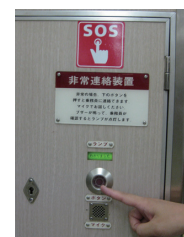
非常連絡装置
