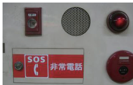
非常連絡装置
