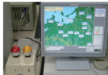
河川水位警報装置
