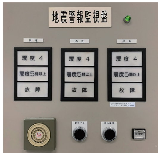
地震警報監視盤
