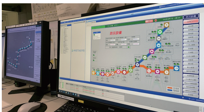
中央防災監視装置（運輸指令）
