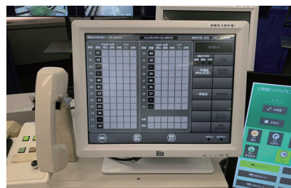
七隈線用列車無線
