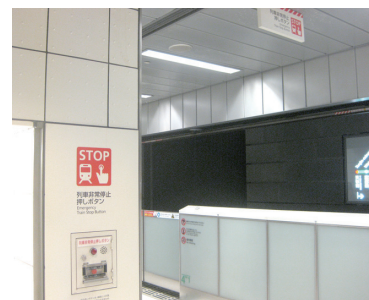
列車非常停止押しボタンと案内板
