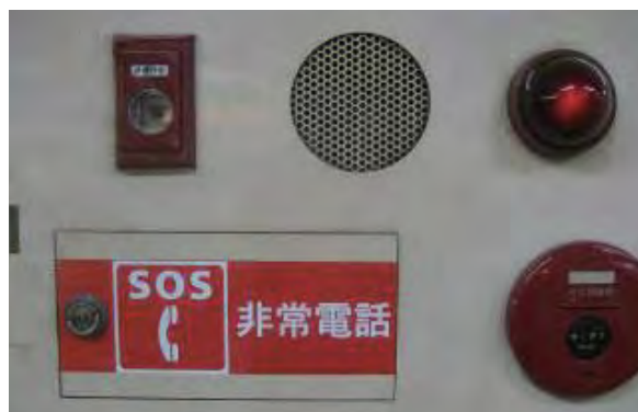
非常連絡装置
