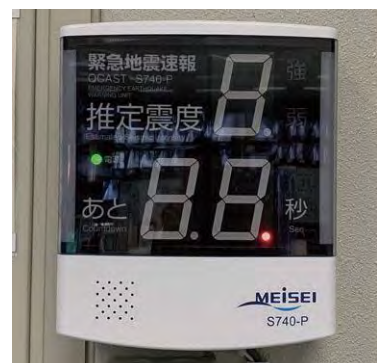
緊急地震速報受信装置
