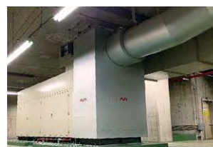
非常用発電機
