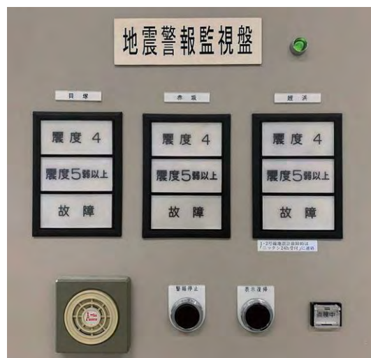
地震警報監視盤
