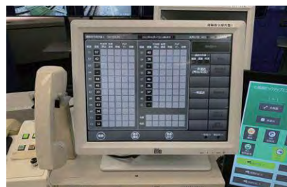
七隈線用列車無線
