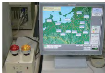
河川水位警報装置
