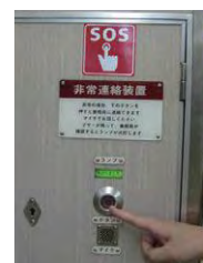
非常連絡装置
