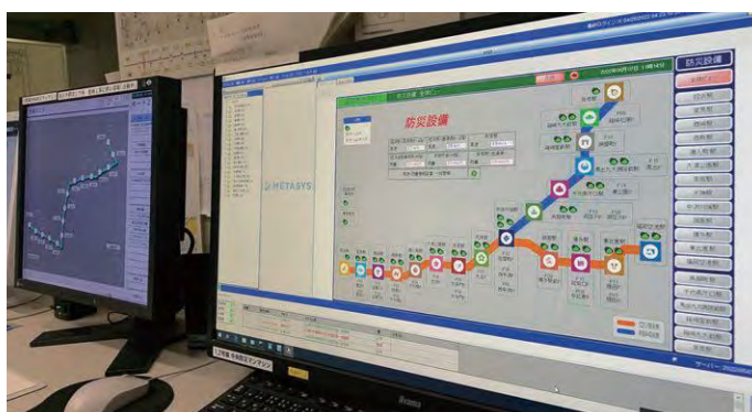
中央防災監視装置（運輸指令）
