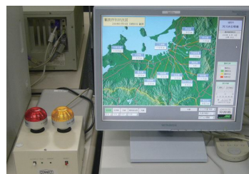
河川水位警報装置
