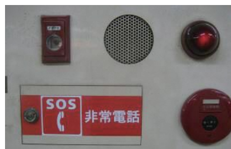
非常連絡装置
