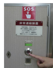
非常連絡装置
