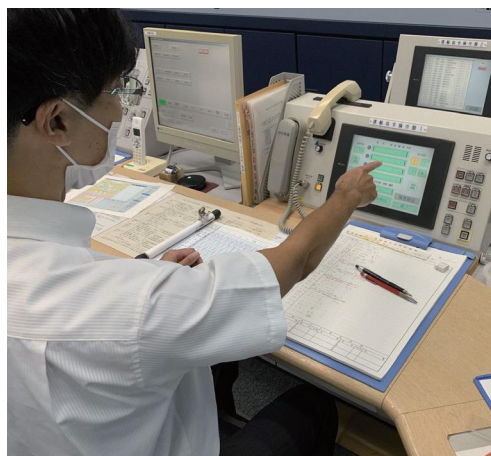
七隈線用列車無線
