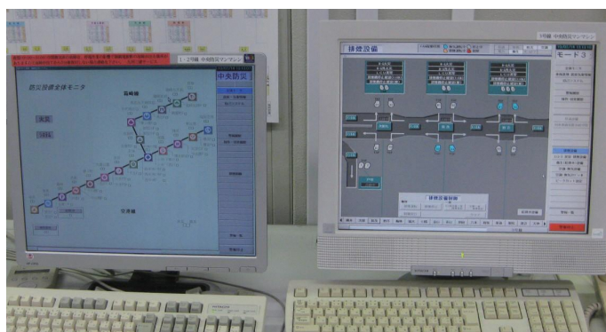
中央防災監視装置（運輸指令）
