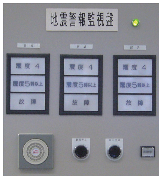
地震警報監視盤
