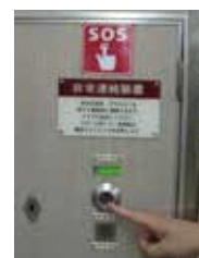
非常連絡装置
