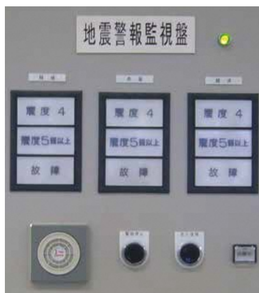
地震警報監視盤
