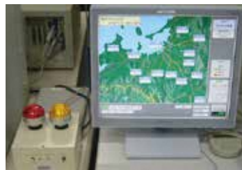
河川水位警報装置
