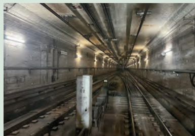
トンネル内照明（空港・箱崎線）
