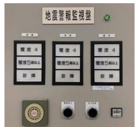
地震警報監視盤
