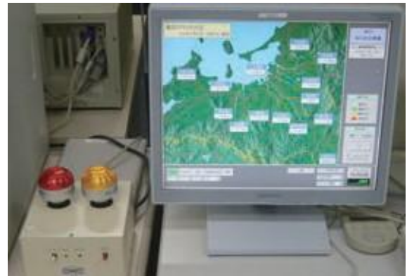
河川水位警報装置
