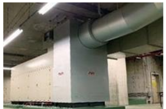
非常用発電機
