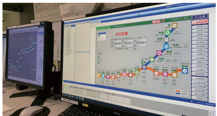
中央防災監視装置(運輸指令)
