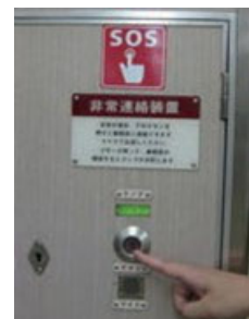
非常連絡装置
