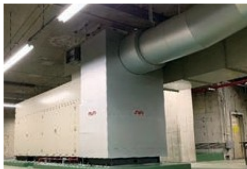
非常用発電機
