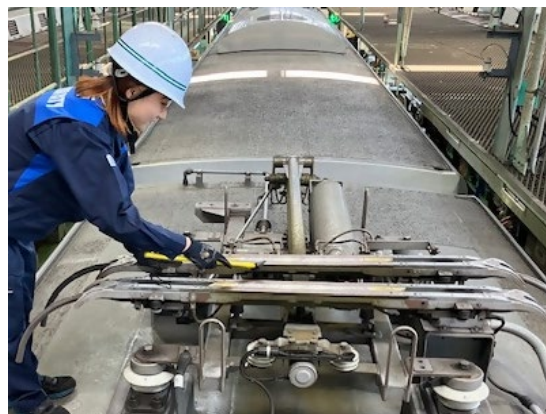
パンタグラフ点検
