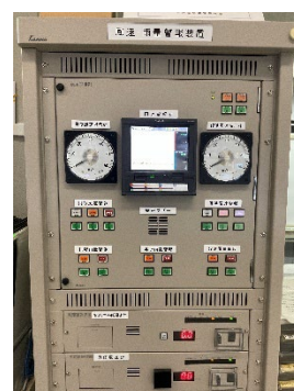
風速雨量警報装置
