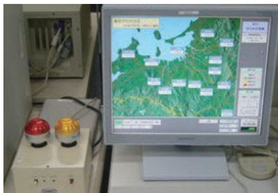
河川水位警報装置
