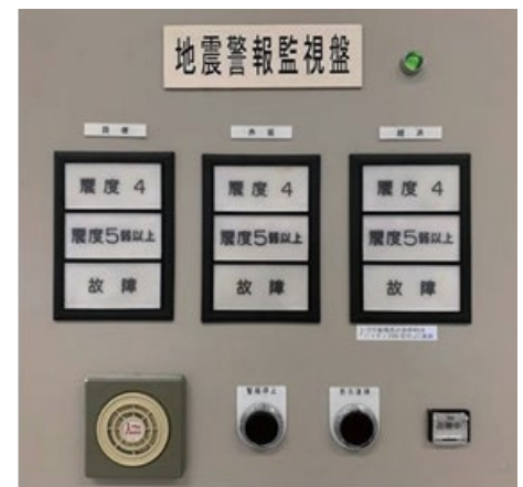
地震警報監視盤
