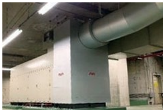
非常用発電機
