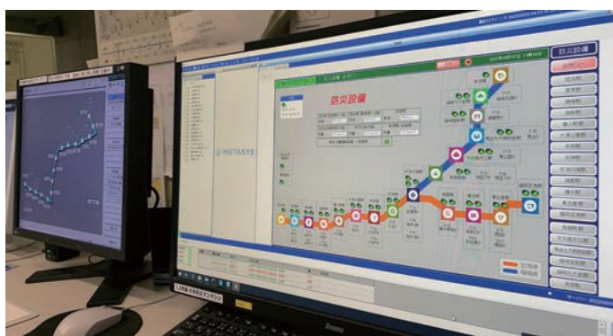
中央防災監視装置(運輸指令)
