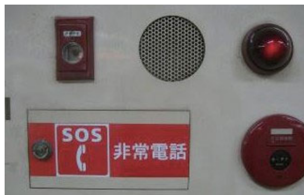
非常連絡装置
