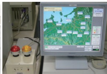
河川水位警報装置
