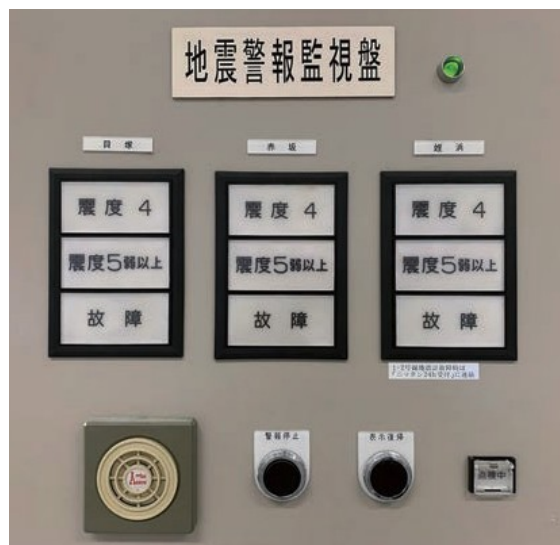
地震警報監視盤
