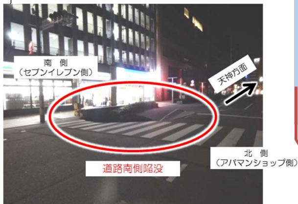
5:20頃 道路南側陥没
