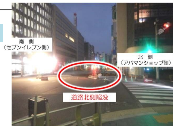
5:30頃 道路北側陥没
